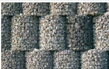
Versetzt angeordnete Rundkörbe
