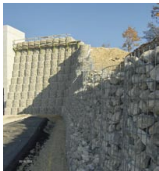
Un mur de soutènement de 14 m de haut en construction sur un site industriel à Laaber, en Bavière
