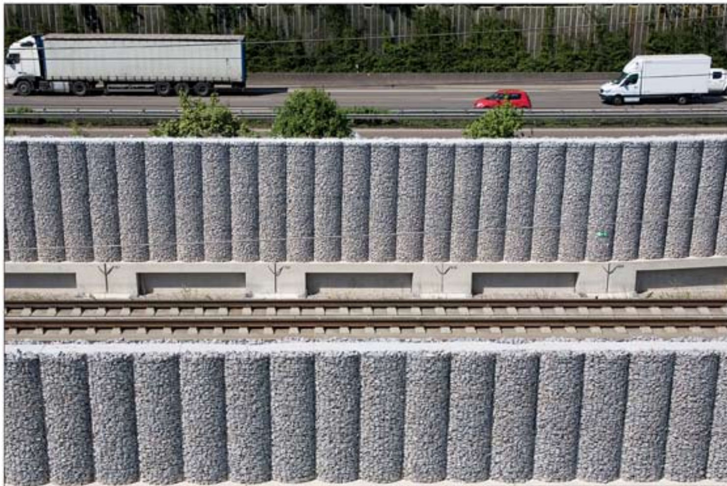
Beidseitig hochabsorbierende Schallschutzwände an einer Hochgeschwindigkeitsstrecke der Bahn.
