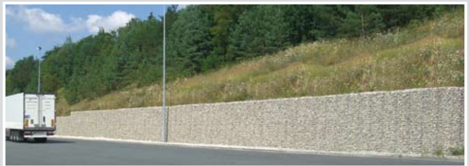
Eine wirtschaftliche Alternative zu herkömmlichen Beton- und Winkelstützmauern. Die 3m hohe Wand wurde in nur 2 Lagen mit 1,50m hohen Körben zeit- und kostensparend aufgebaut. (Firmengelände in Feucht / Bayern, Abb. u.)
